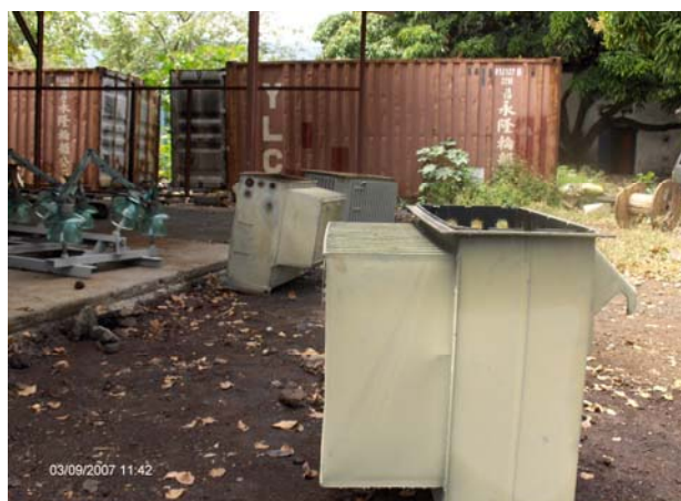
Photo 8 : Stockage à ciel ouvert de transformateurs, centrale électrique de Ma-Mwé, Moroni
